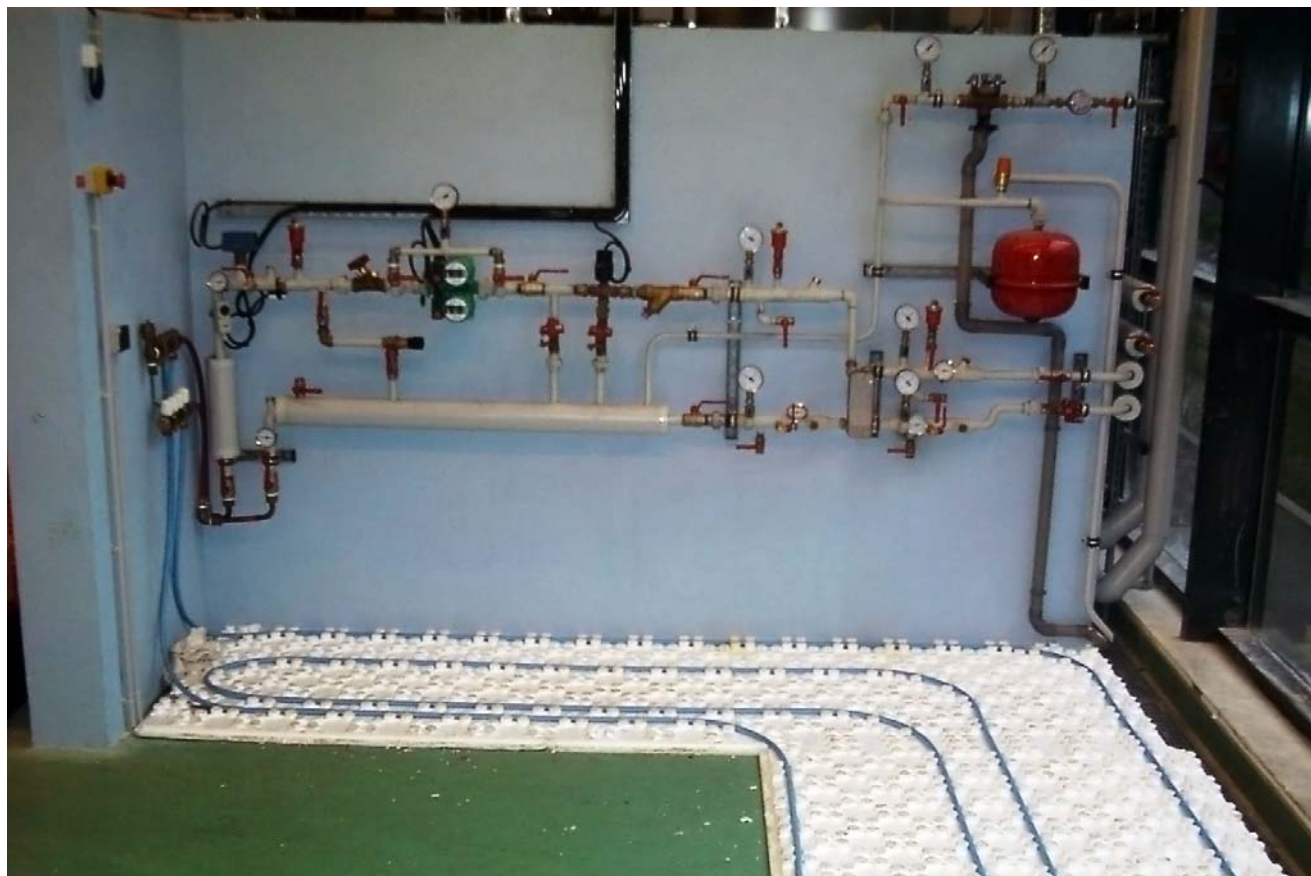
Photothèque GEEEn - Plaque-forme de mise en œuvre de chauffage au sol dans une maison
