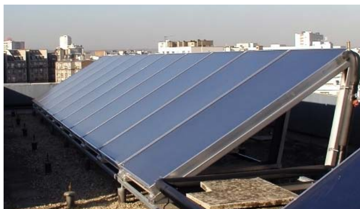
Photo : ADEME - Chauffe-eau solaire
